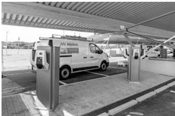
Ladesäulen mit je vier Ladepunkten
